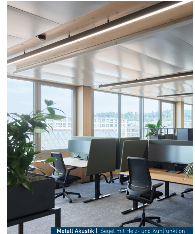
Metall Akustik | Segel mit Heiz- und Kühlfunktion
