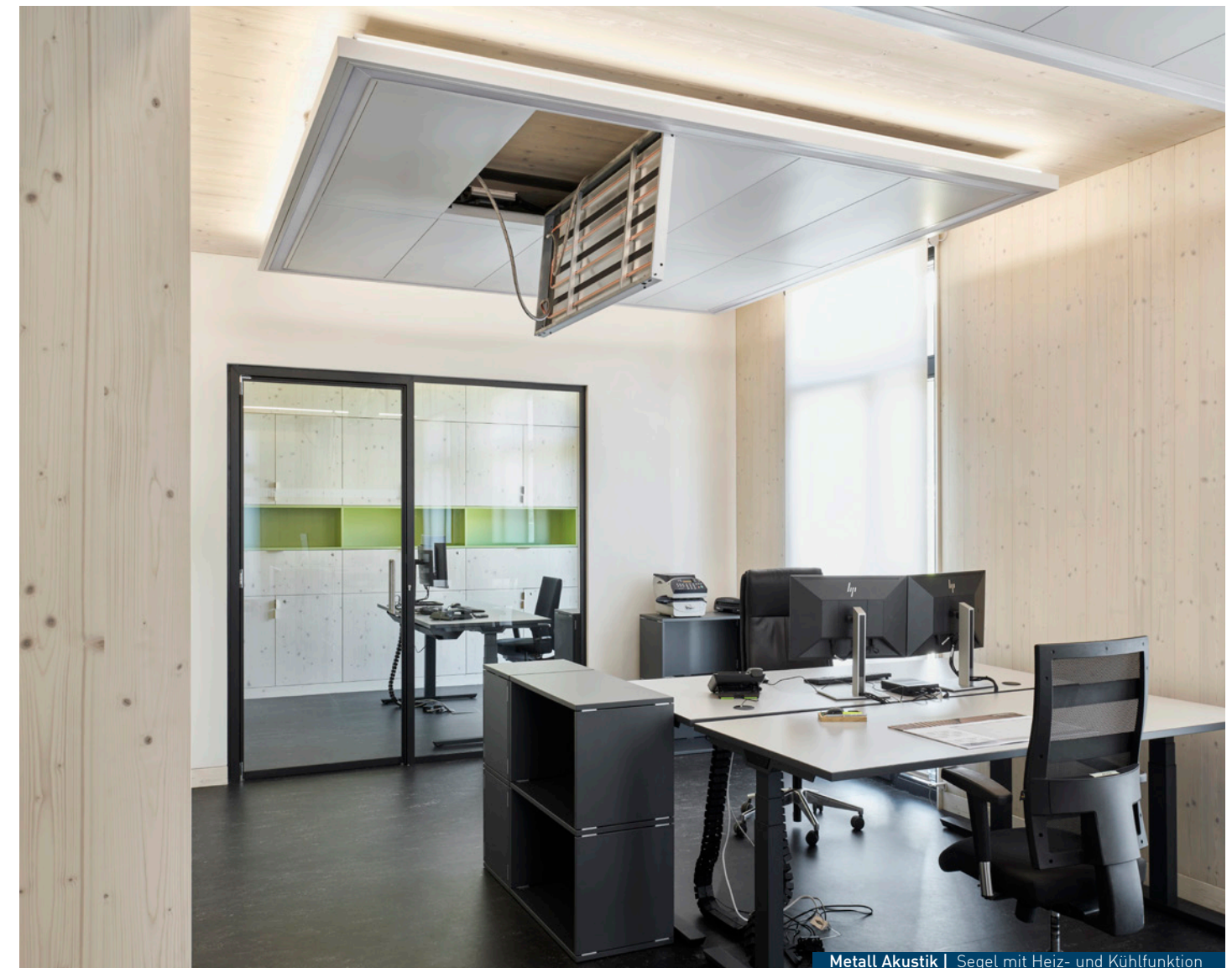
Metall Akustik | Segel mit Heiz- und Kühlfunktion
