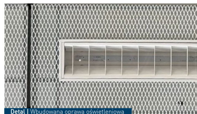
Detal | Wbudowana oprawa oświetleniowa
