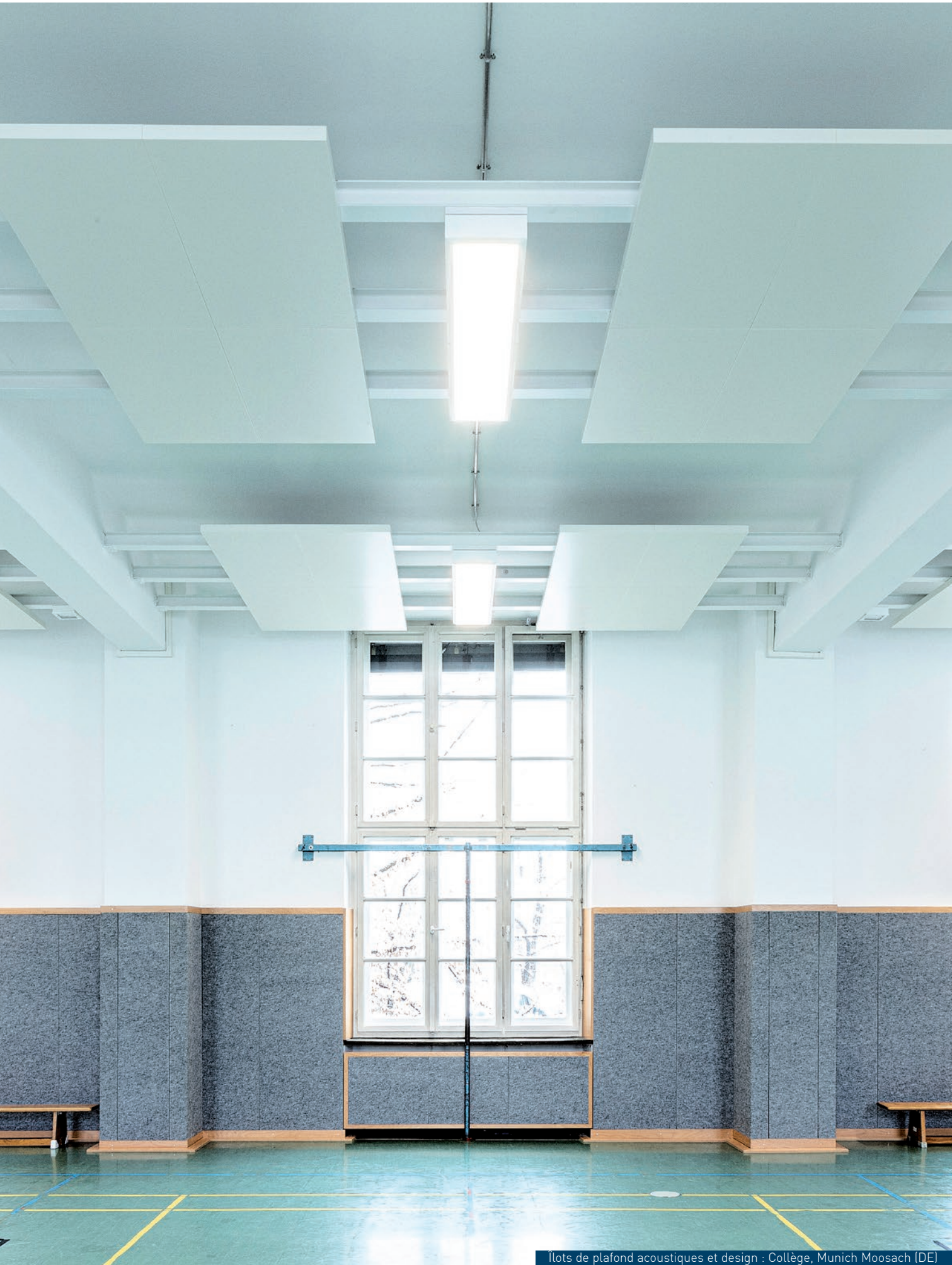
Îlots de plafond acoustiques et design : Collège, Munich Moosach (DE)
