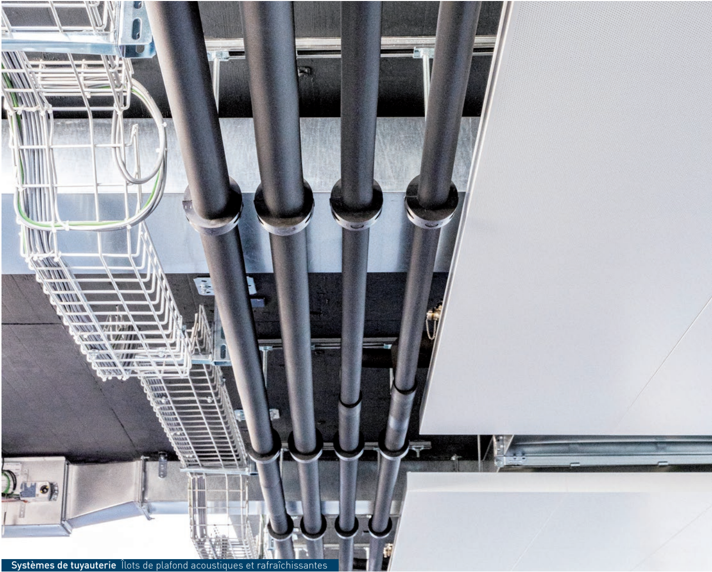
Systèmes de tuyauterie Îlots de plafond acoustiques et rafraîchissantes
