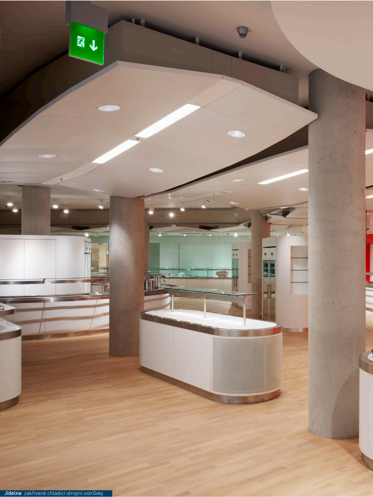
Jídelna zakřivené chladicí stropní ostrůvky
