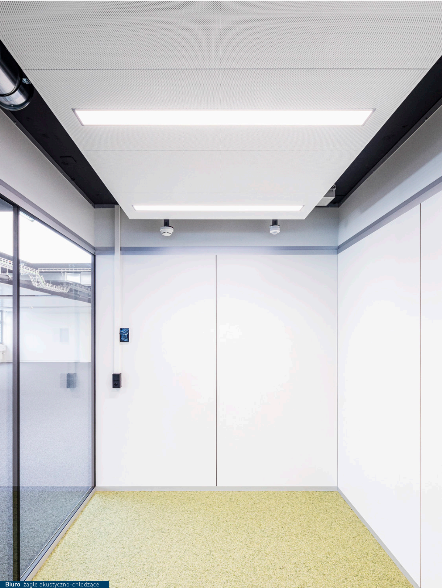
Biuro żagle akustyczno-chłodzące
