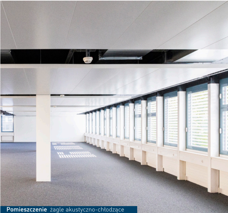
Pomieszczenie żagle akustyczno-chłodzące
